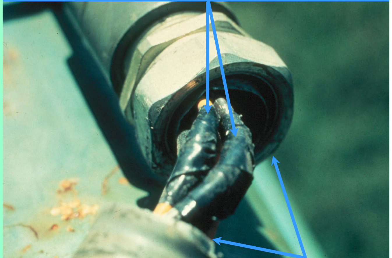
Broken Conduit Joint
